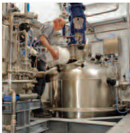
In Bioreaktoren werden Nematoden vermehrt. Foto: e-nema GmbH
